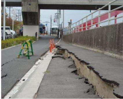
堤防側の歩道に亀裂による段差 (浦安市今川地区)
