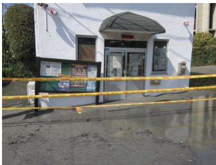
液状化による 不同沈下が見られる交番 (浦安市富岡地区の交番)
