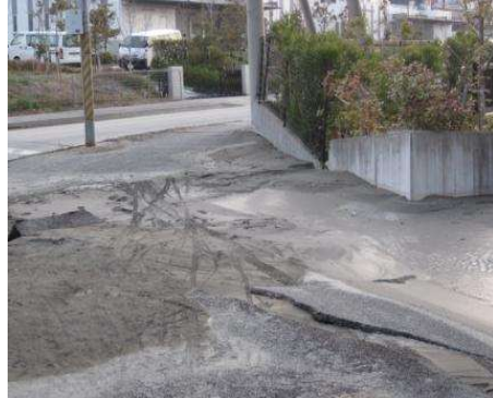
道路の亀裂から泥が噴き出した状態 (浦安市千鳥地区)
