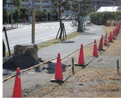
歩道上に突出したマンホール (浦安市日の出地区)
