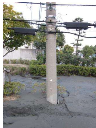
歩道の亀裂から噴き出た泥で電柱が 大きく沈下し埋まった状態 (浦安市千鳥地区)
