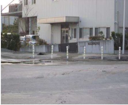
噴砂と沈下により傾いた工場外壁 (浦安市千鳥地区)
