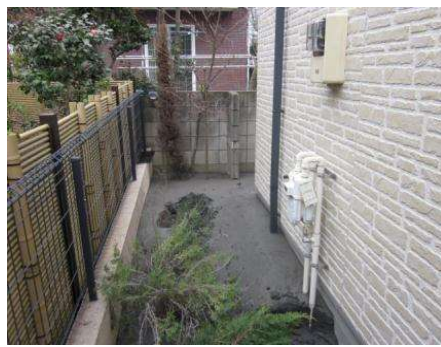
宅地内に噴き出た噴砂 (浦安市今川地区)
