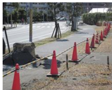
写真2 歩道上に突出したマンホール(浦安市日の出地区)
