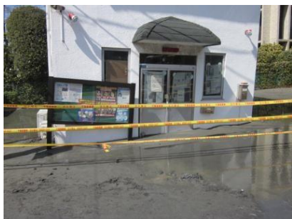
写真1 液状化による不同沈下が見られる交番浦安市富岡地区
